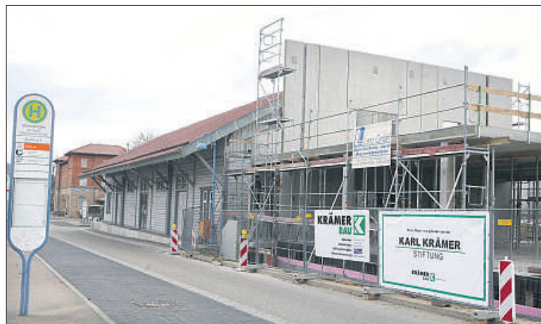
Die Betonteile des Feuerwehrmuseumsanbaus sind fertig, demnächst kommen die Stahlbauer. Im ersten Stock wird die Cafeteria eingerichtet, von dort schauen die Gäste auf die Fahrzeuge im Erdgeschoss.
